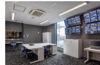
■ 防災センター
