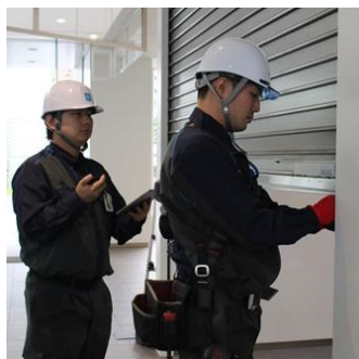
防火シャッターの法定点検
