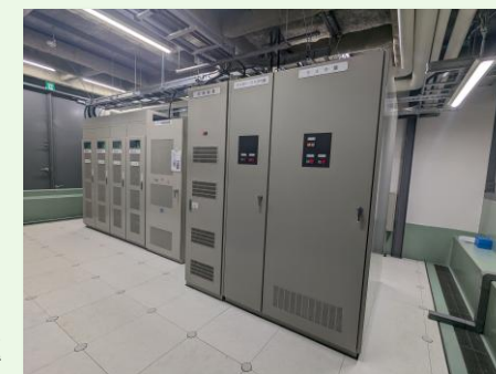
広島駅の回生電力貯蔵装置
