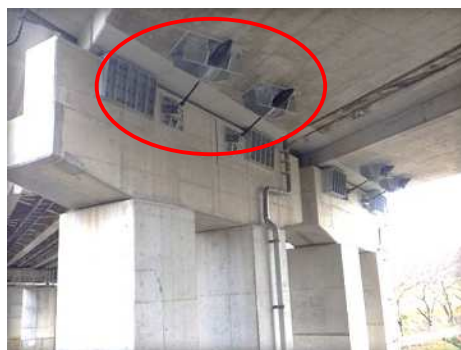
落橋防止システム
