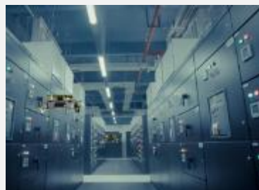
データセンター監視
